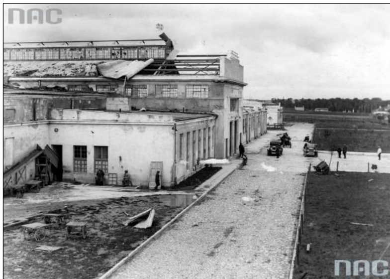
Ryc. 6. Zerwany dach nad rzeźnią miejską
